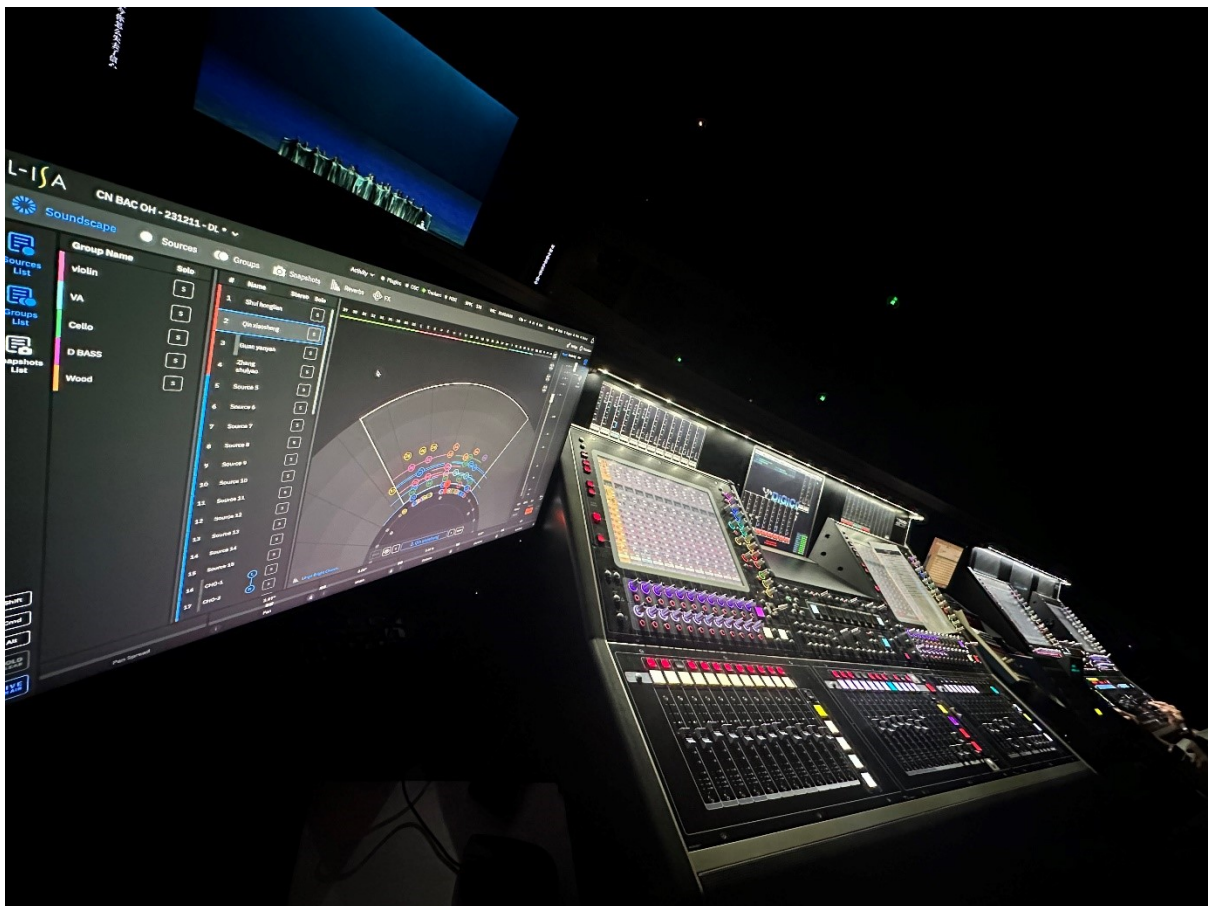
Redundanz im Bereich Live Audio: Zwei gespiegelte DiGiCo Quantum 5 Konsolen am FOH-Platz der Oper „The Canal Ballad“ während der Eröffnungsvorstellung am Beijing Performing Arts Centre im Dezember 2023 (Bild mit freundlicher Genehmigung von Racpro)
